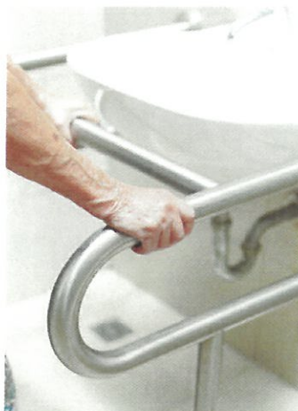
Barras de apoyo
